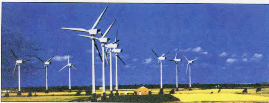
Εικ. 4.20. Εγκατάσταση ανεμογεννητριών ισχύος 3MW στο Emden της Γερμανίας.
