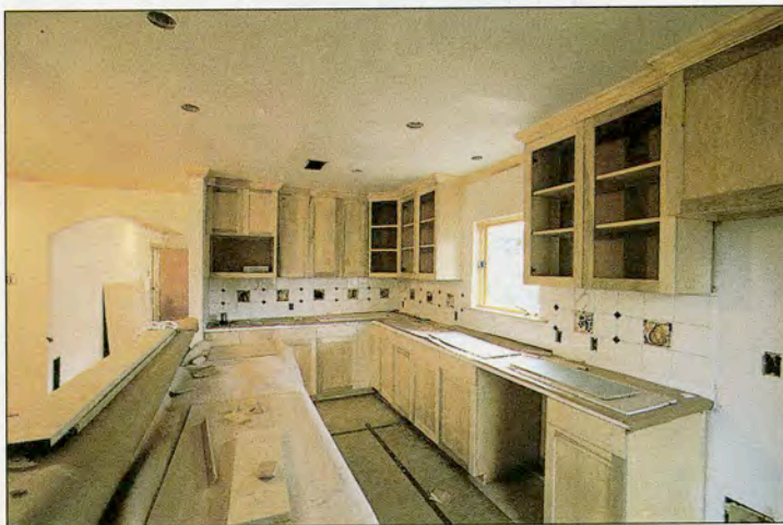
Εικ. 6.16. Ντουλάπια εσωτερικών χώρων (κουζίνας).
