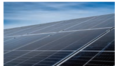
Εικόνα 3.2 Φωτοβολταϊκά στοιχεία (μετατρέπουν την ηλιακή ενέργεια σε ηλεκτρική).
